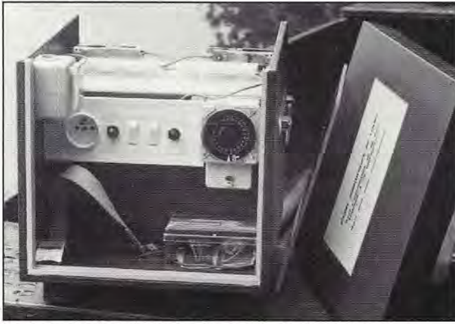
Vue du panneau d'alimentation électrique dans son coffre. (Cliché J.L. Dommanget).
