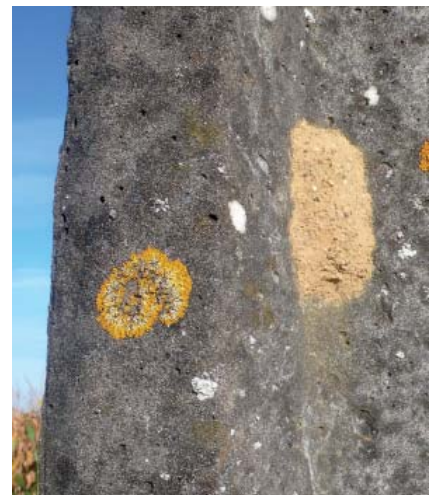
Nid d'Eumène onguiculé sur un poteau électrique en ciment
